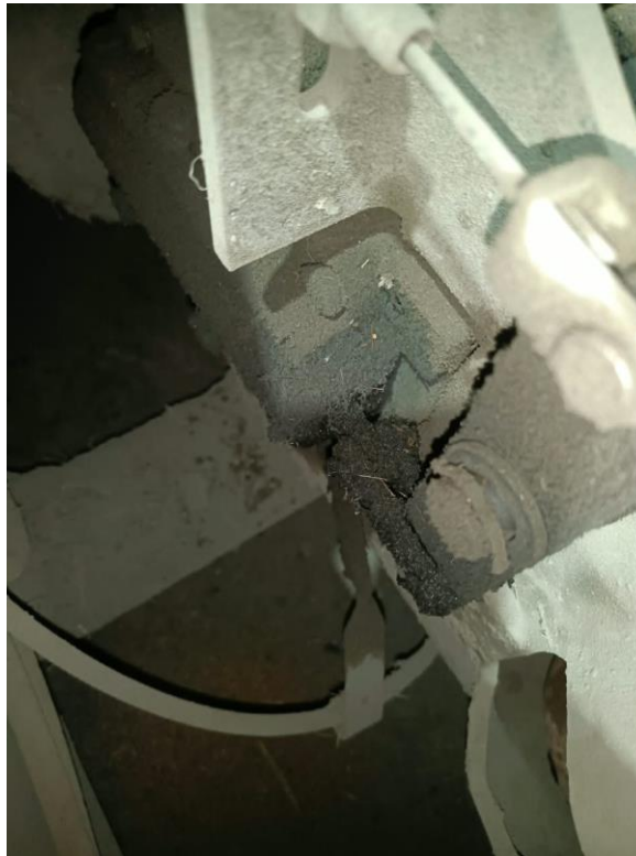
FUGA EN RETEN DE LICHE
