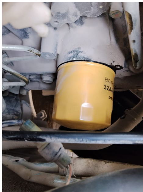
FILTRO DE ACEITE DE MOTOR INSTALADO
