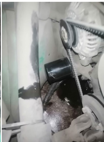
FILTRO DE ACEITE DE MOTOR INSTALADO
