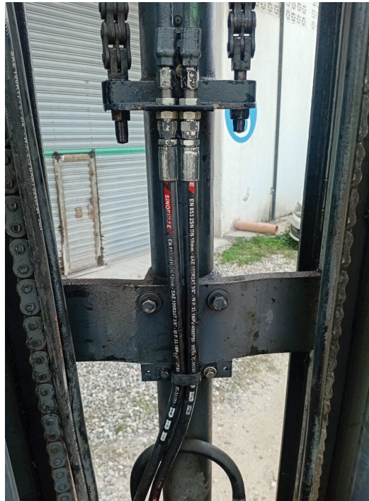
BASE PARA MANGUERAS INSTALADA
