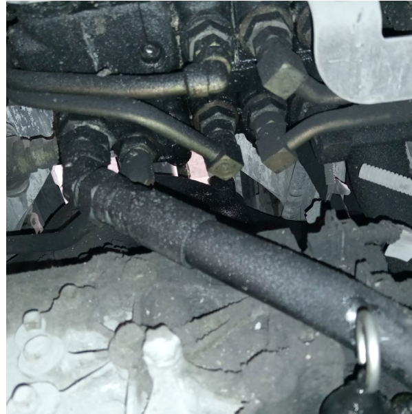
FUGA EN EL BANCO HIDRAULICO
