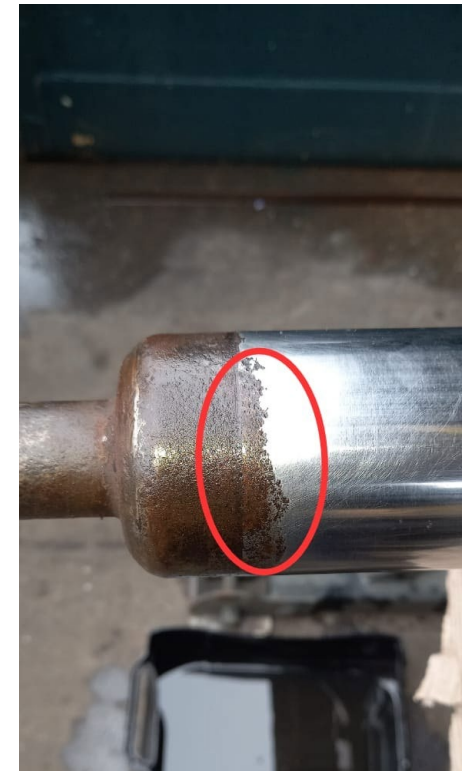
Daño por corrosión
